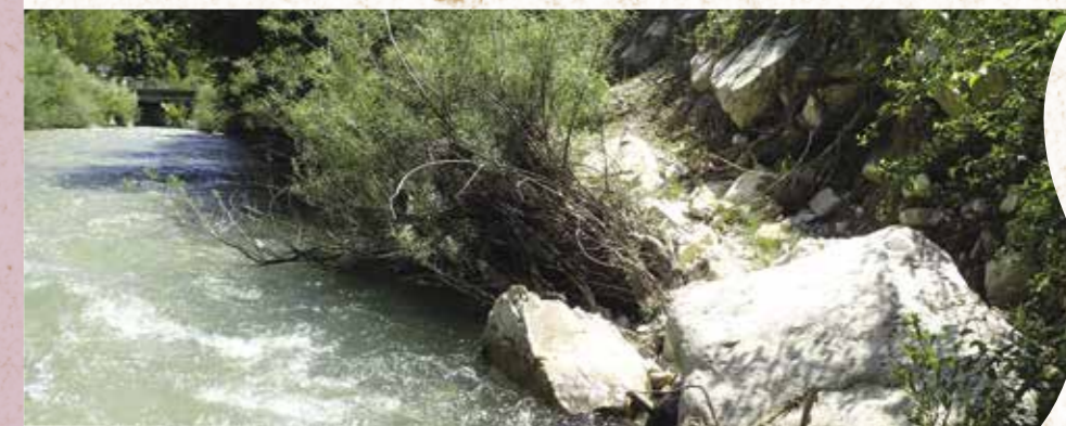
Dégradation de la digue à La Faurie liée à l'incision du lit
