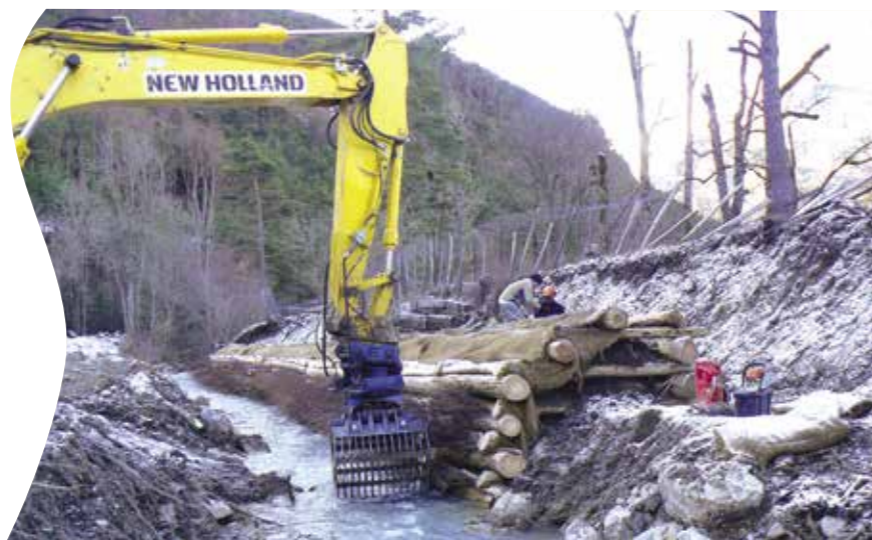
Travaux de restauration de la digue de Bouriane à St Julien en Beauchêne en 2013.
